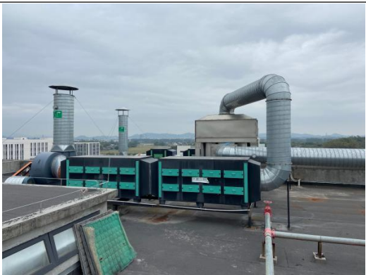
水喷淋+干式过滤器+二级活性炭（DA002）
