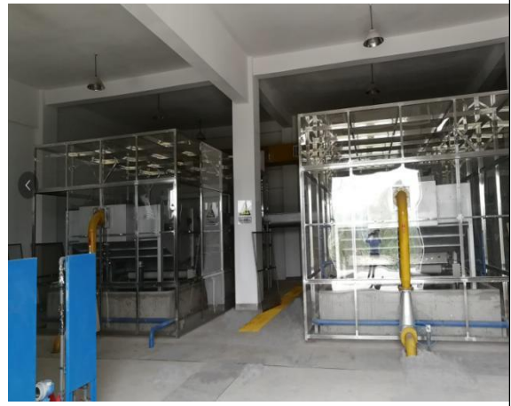
图 4-3 设备密闭工房收集实例
