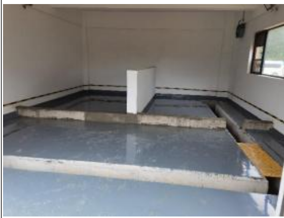
危废暂存间（防渗）
