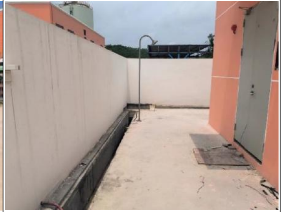
车间供油站应急收集边沟
