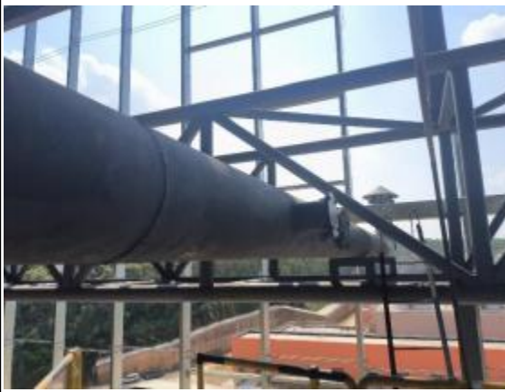
一般废气排放口 (DA003)
