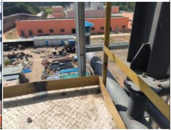
一般废气排放口 (DA004)
