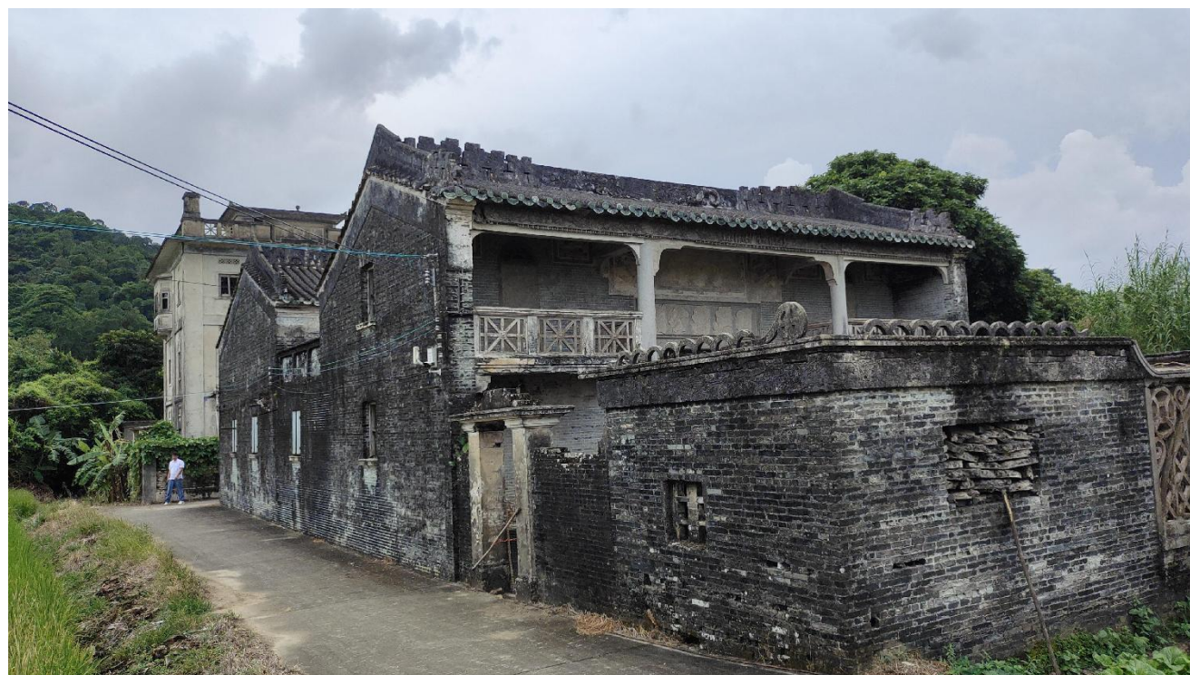
部分传统风貌建筑空置，缺乏有效管护，风貌不显
