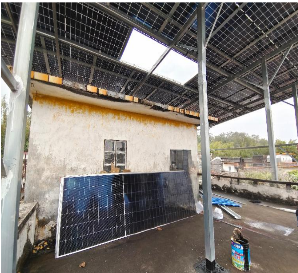
图一（事发现场-光伏屋面）
