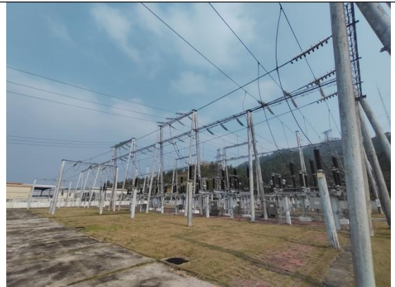
110kV 配电装置场地
